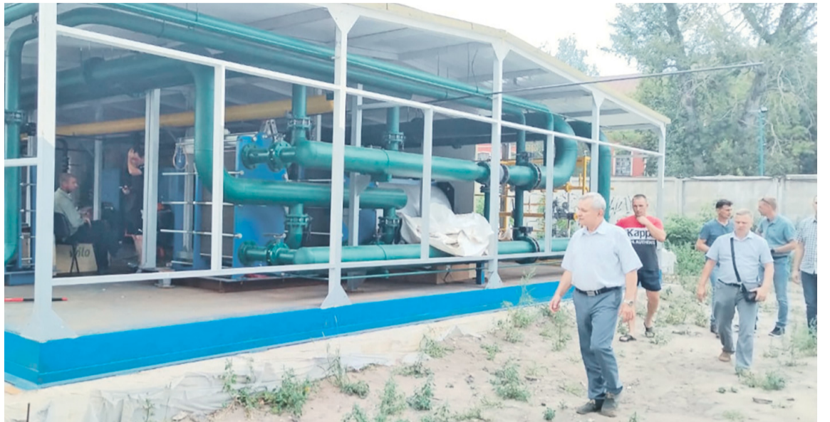
Возведение котельных на улицах Юрия Сергеева и Ленина позволит обеспечить качественным теплоснабжением 1450 жителей города.
