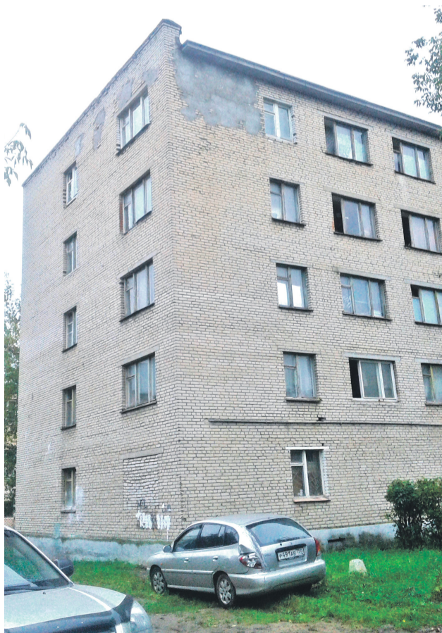
ВИД С УЛИЦЫ. Постоянные коммунальные аварии стремительно разрушают стены здания.
