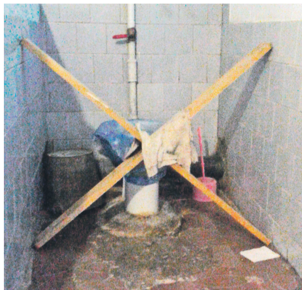
СЮДА НЕЛЬЗЯ! Многие унитаза в туалетных комнатах экс-общежития не работают вообще.
