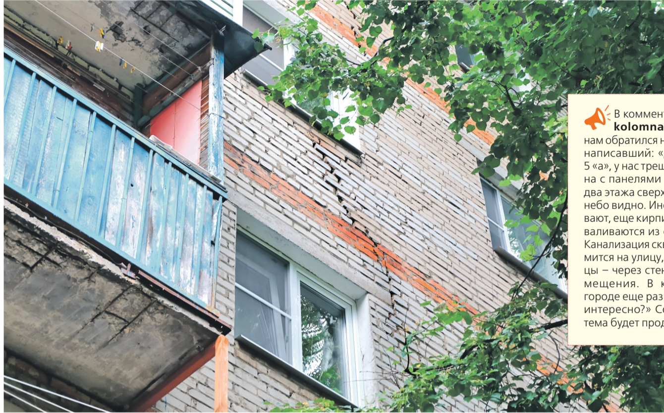
ТРЕЩИНА ПОЛЗЕТ по стене, жители обеспокоены.
