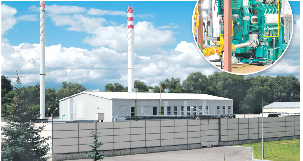
МИНИ-ТЭЦ состоит из энергоблока и пиковой мини-котельной. Работу обеспечивают три газопоршневые генераторные установки. Их мощность 1,75 МВт электроэнергии и 1,27 Гкал тепловой энергии.
