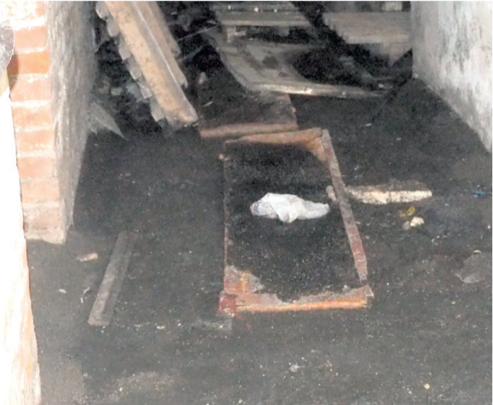
Подвал полон нечистот.
