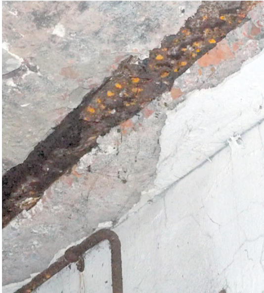
Балки на потолке подвала выступили наружу.
