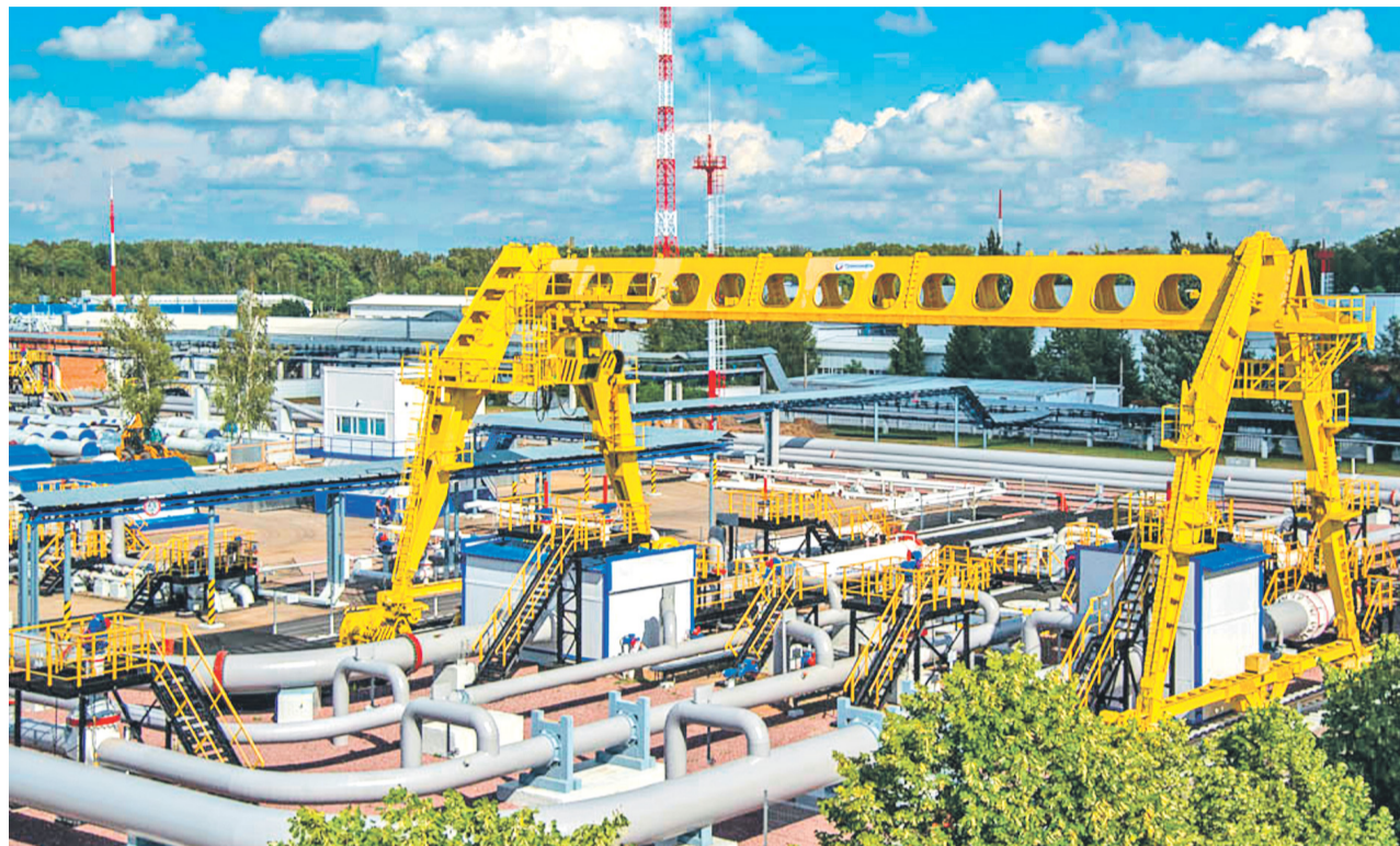
Гордость АО «ТРАНСНЕФТЬ – ДИАСКАН» – испытательный полигон для внутритрубных приборов.
