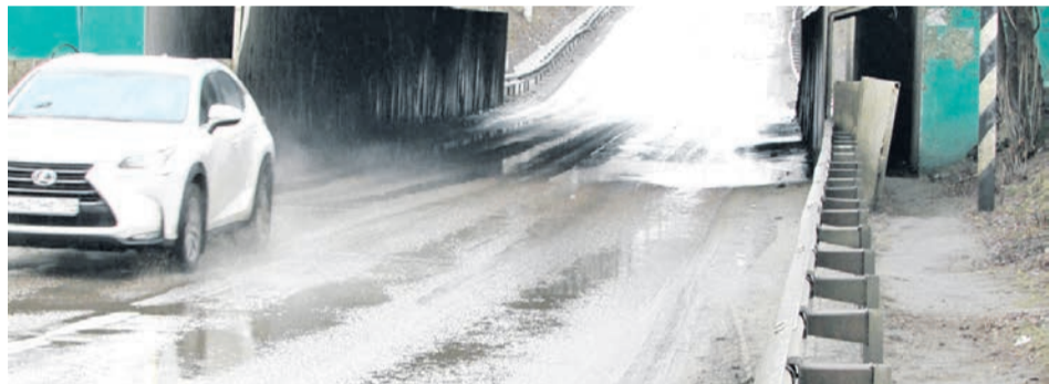
АСФАЛТ на ул. Пароходной держится уже три года.
