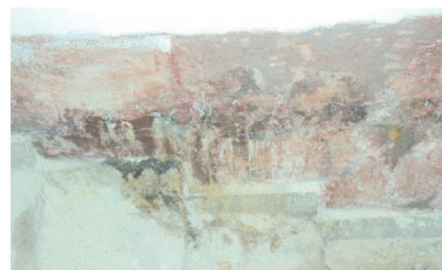
Есть проблемы с гидроизоляцией в строящемся перинатальном центре. Стены покрылись пятнами и подтеками от сырости, штукатурка отваливается.
