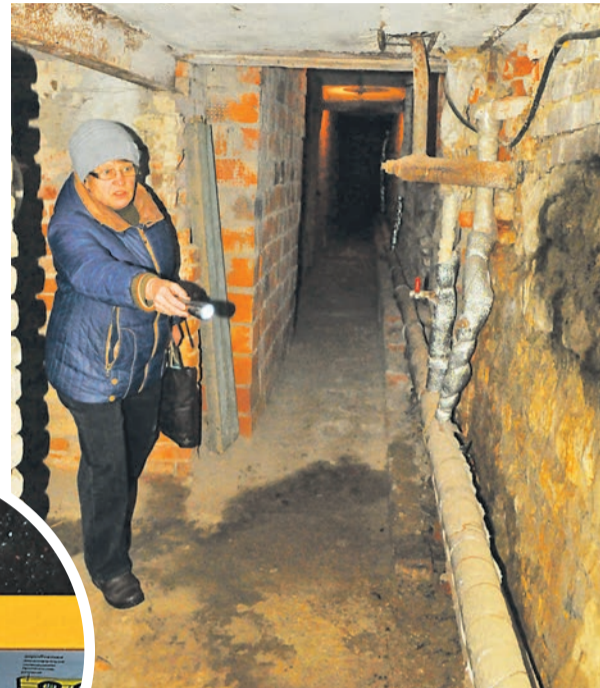
СЫРОСТЬ. Попадающая в подъезд вода — причина сырости в подвале, утверждают жители.
