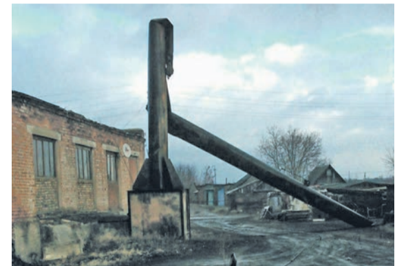
БОБРЕНОВО. У сельской котельной сдуло трубу.
