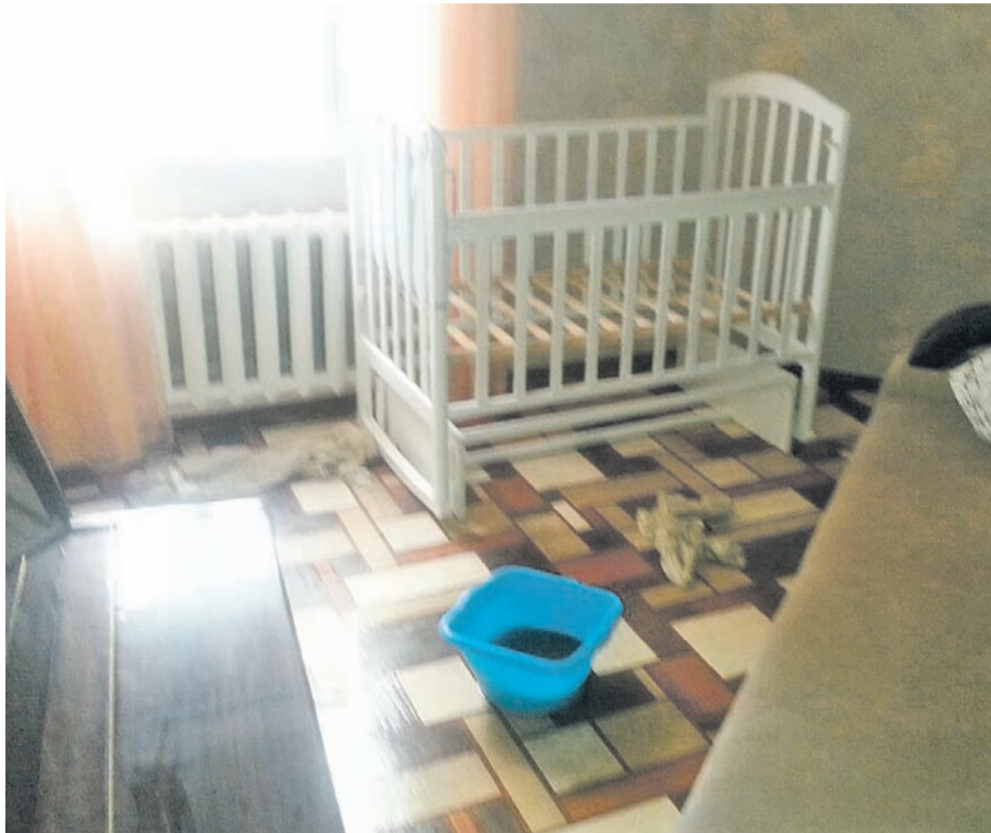
КВАРТИРА № 10 спустя несколько часов после устранения аварии. Из детской кроватки пришлось убрать испорченные постельные принадлежности. Фото: архив жильцов
